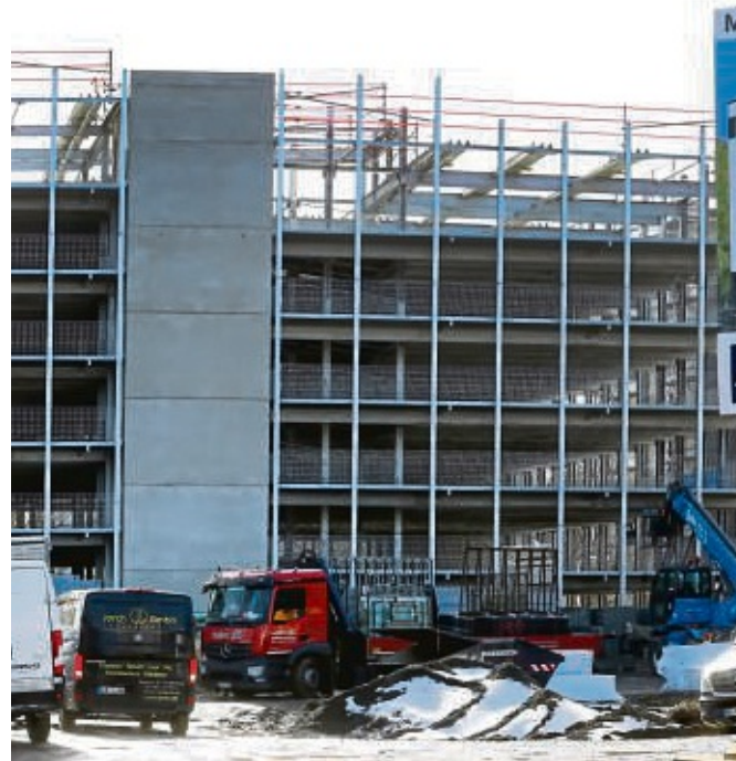
Das Baugewerbe hat gut zu tun: Ein Projekt von vielen in Kassel ist der Magazin Hof.
